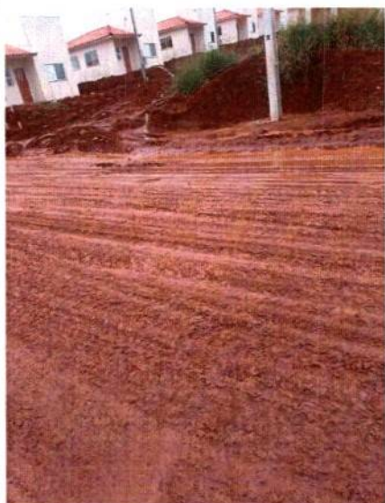
Imagem 1: Entupimento do sistema de drenagem de águas pluviais devido ao deslizamento de terra e aterramento da pavimentação em CBUQ existente. Fonte: PMJ
