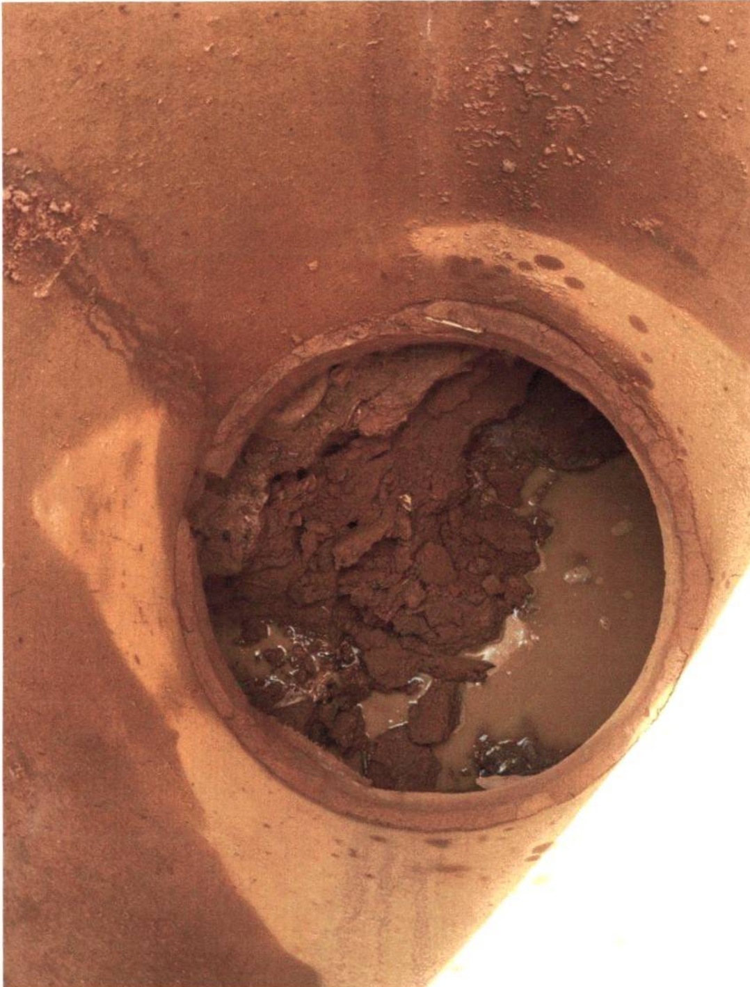
Imagem 08: Desobstrução de PV de drenagem e Bocas de lobos no dia 15/09/2022, onde os moradores reclamavam que a água das chuvas dos terrenos pertencentes ao município obstruiu com barro a rede de drenagem. Imagem 09: Desobstrução de PV de drenagem e Bocas de lobos no dia 15/09/2022, onde os moradores reclamavam que a água das chuvas dos terrenos pertencentes ao município obstruiu com barro a rede de drenagem.
