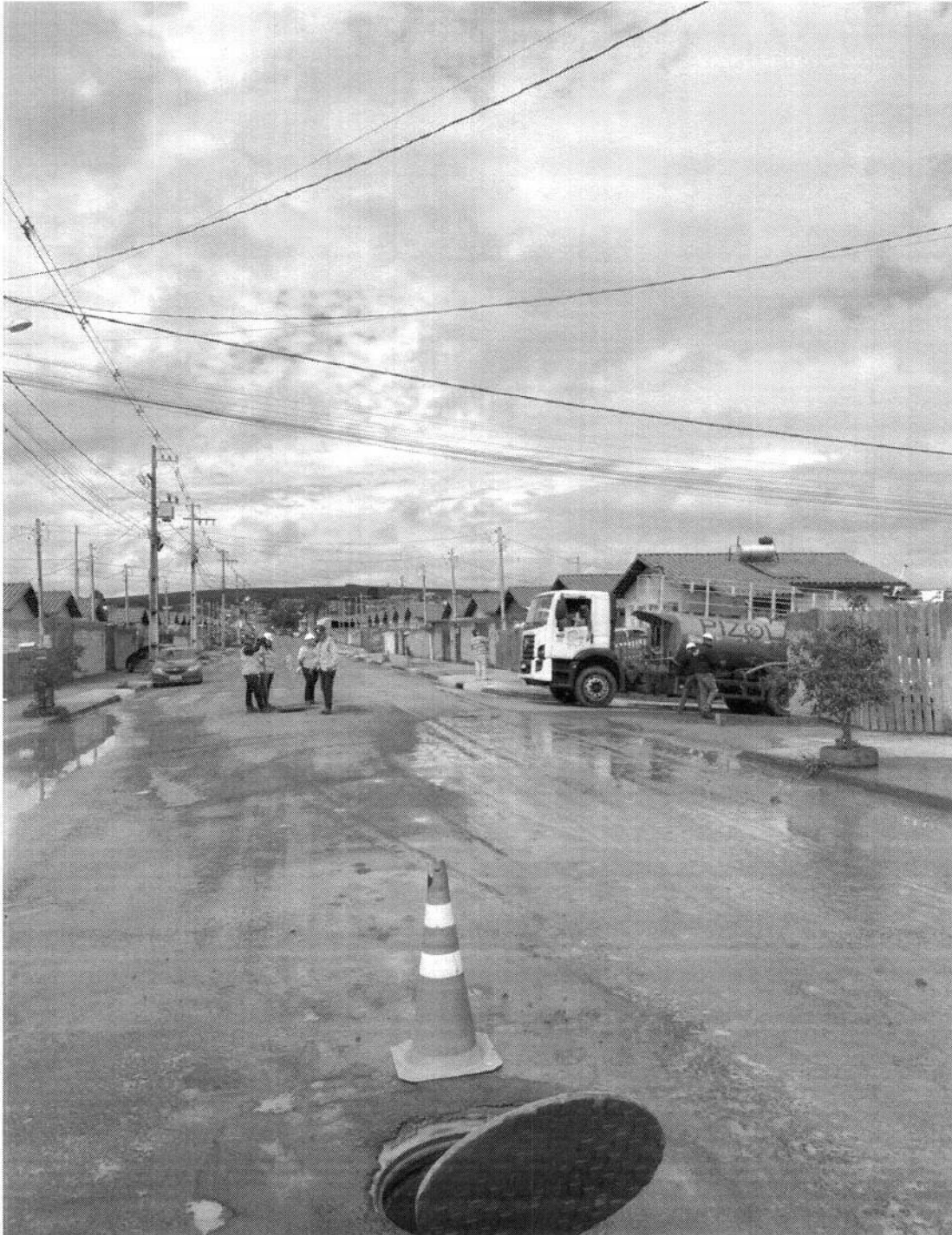
Imagem 07: Desobstrução de PV de drenagem e bocas de lobo no dia 15/09/2022, onde os moradores de Araponga e Rouxinol pediram ajuda para a empresa Pizolato pois a água das chuvas dos terrenos pertencentes ao município obstruíram com barro a rede de drenagem. o município deve verificar sobre a inclusão de cobertura com camada vegetal afim de minimizar os danos causados à empreendimentos que não são de responsabilidade da empresa Pizolato.
