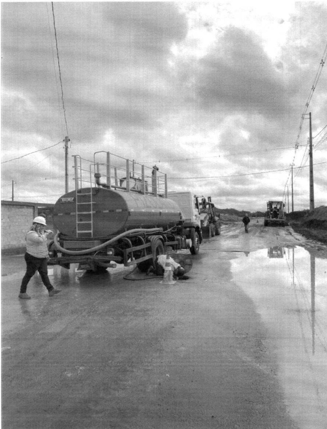
Imagem 06: Desobstrução de PV de drenagem e bocas de lobo no dia 15/09/2022, onde os moradores de Araponga e Rouxinol pediram ajuda para a empresa Pizolato pois a água das chuvas dos terrenos pertencentes ao município obstruíram com barro a rede de drenagem. o município deve verificar sobre a inclusão de cobertura com camada vegetal afim de minimizar os danos causados a empreendimentos que não são de responsabilidade da empresa Pizolato.
