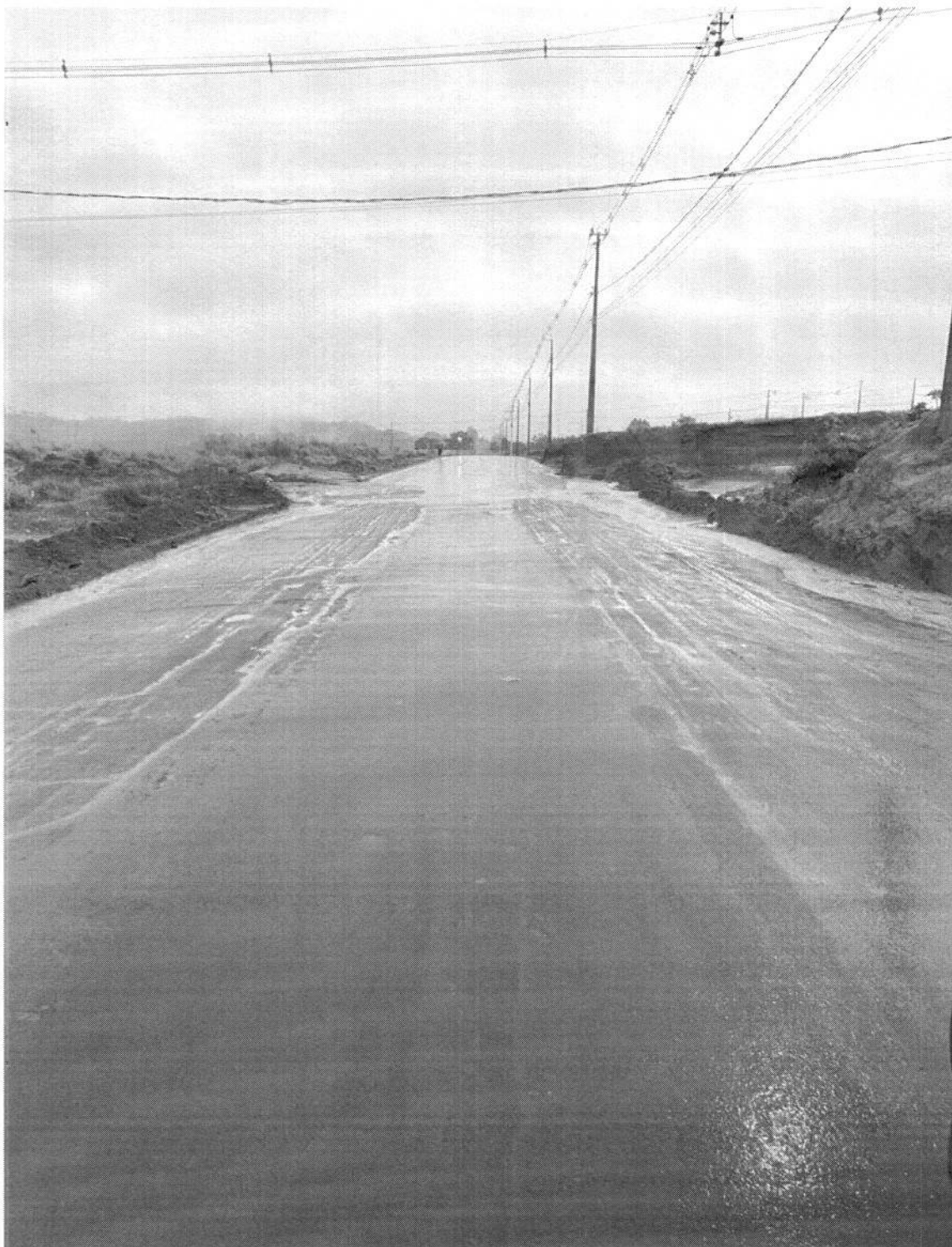
Imagem 04: Terras de áreas pertencentes ao município de Jaguariaíva sendo arrastadas pelas chuvas causando danos a rede pluvial e danos a limpeza urbana.
