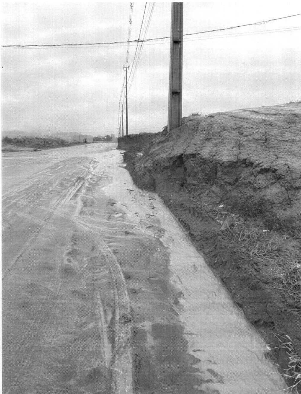
Imagem 03: Terras de áreas pertencentes ao município de Jaguariaíva sendo arrastadas pelas chuvas causando danos a rede pluvial e danos a limpeza urbana.
