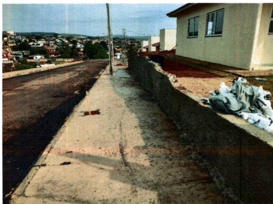
FOTO 03: MURO SEM ACABAMENTO E CALÇADAS IRREGULARES
