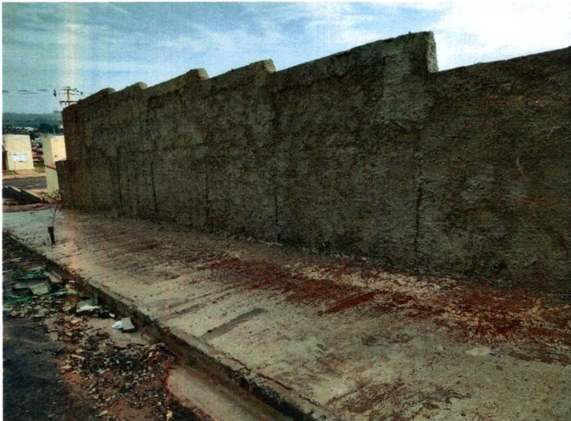
FOTO 01: MURO SEM ACABAMENTO E CALÇADAS IRREGULARES
