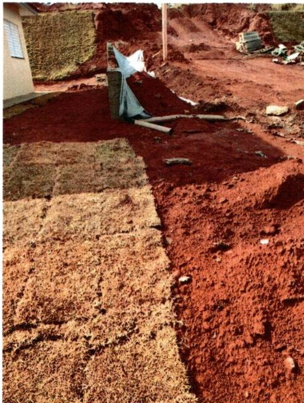
FOTO 05: MURO SEM ACABAMENTO AINDA NÃO FINALIZADO COM DRENAGEM PRECÁRIA E TALUDE AINDA NÃO FINALIZADO E SEM CAMADA VEGETAL
