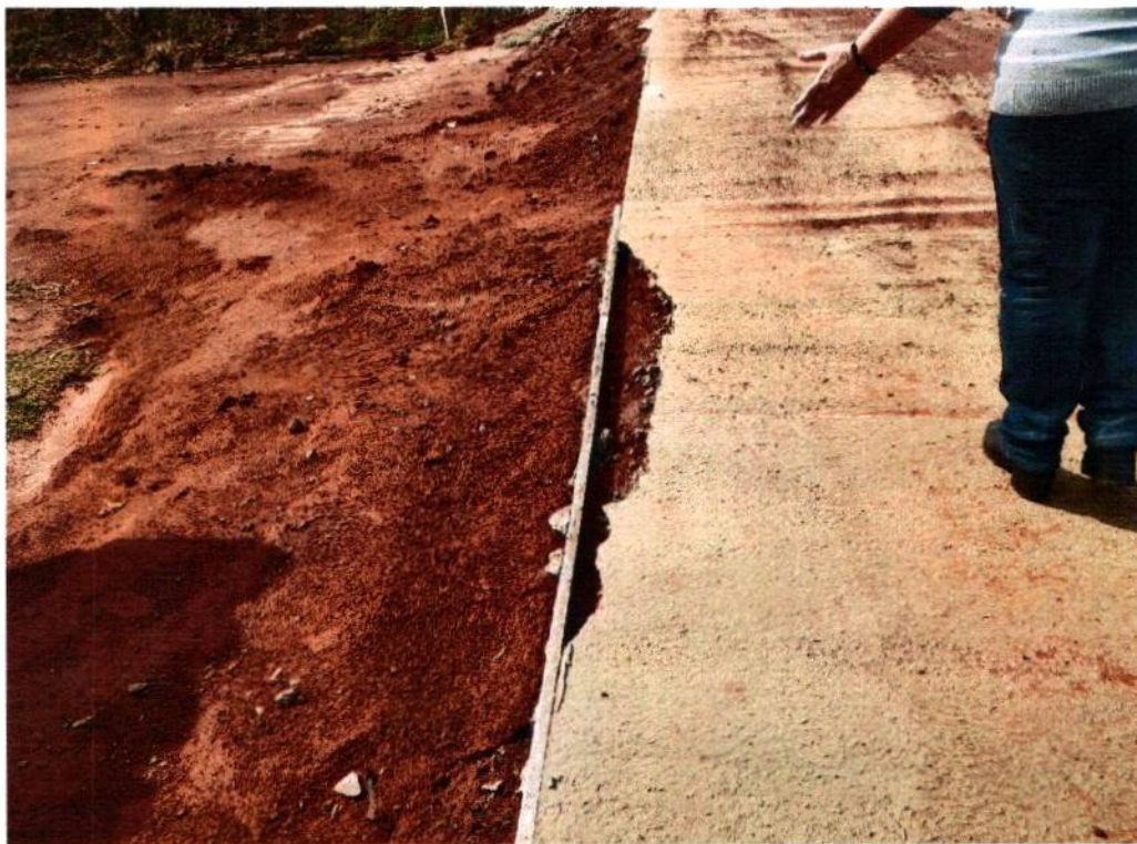
FOTO 20: CALÇADAS DANIFICADAS E NÃO ATENDEM CONDIÇÕES MÍNIMAS DE ACESSIBILIDADE
