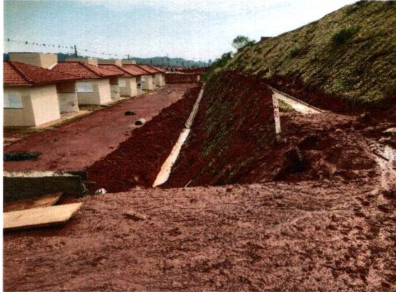
FOTO 26: CANALETAS DE DRENAGEM DE ÁGUAS PLUVIAIS
