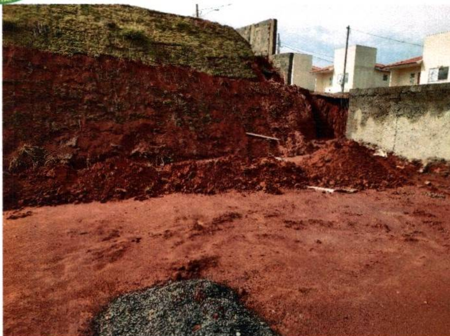
FOTO 13: TALUDE SEM COMPACTAÇÃO, COM INCLINAÇÃO SUPERIOR A MÍNIMA RECOMENDADA E SEM COBERTURA VEGETAL
