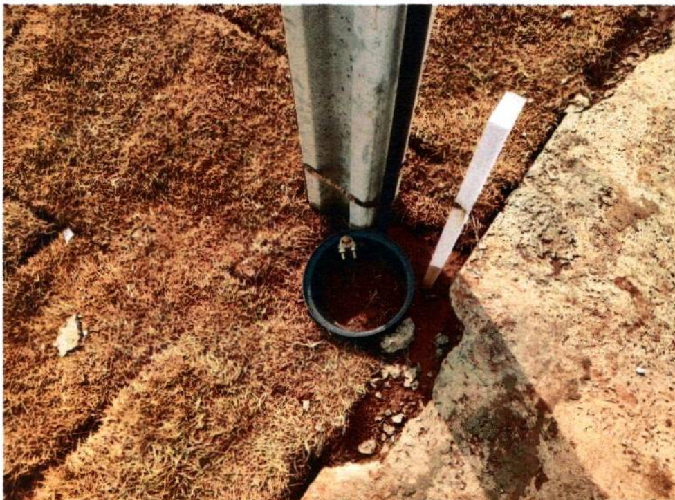
FOTO 07: ENTRADA DE ENERGIA
