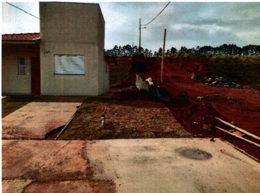
FOTO 22: CALÇADAS DANIFICADAS E NÃO ATENDEM CONDIÇÕES MÍNIMAS DE ACESSIBILIDADE
