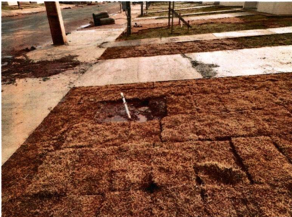
FOTO 29: ENTRADA DE ÁGUA
