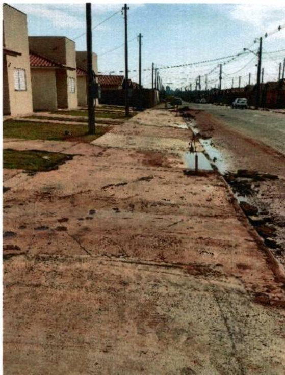
FOTO 23: CALÇADAS DANIFICADAS E NÃO ATENDEM CONDIÇÕES MÍNIMAS DE ACESSIBILIDADE, A GUIA DE ENTRADA VEICULAR NÃO FOI REBAIXADA
