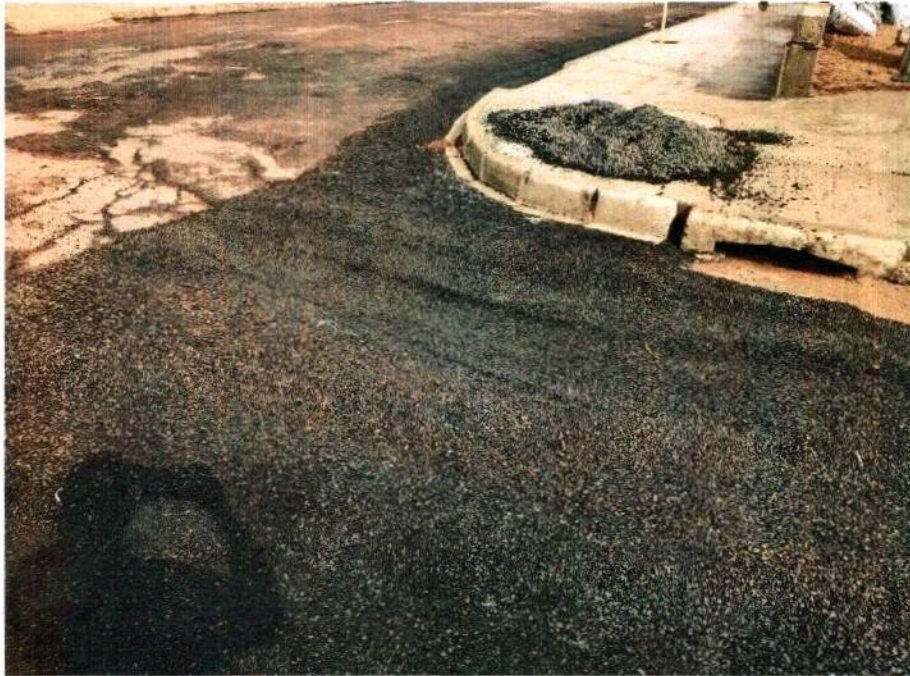
FOTO 15: MEIO FIO SEM REJUNTAMENTO, CALÇADAS NÃO ATENDEM CONDIÇÕES MÍNIMAS DE ACESSIBILIDADE
