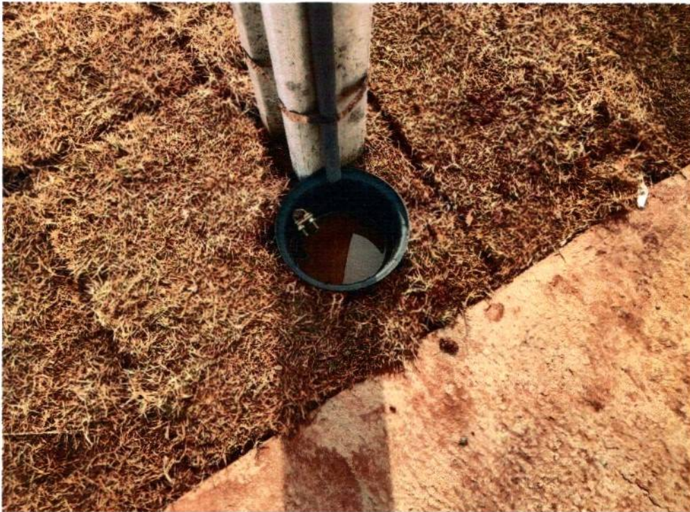
FOTO 07: ENTRADA DE ENERGIA
