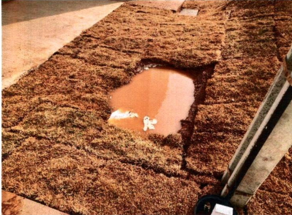
FOTO 32: ENTRADA DE ÁGUA
