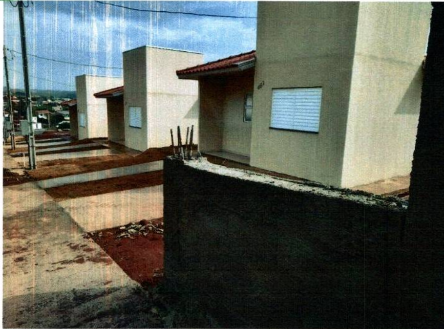
FOTO 04: MURO SEM ACABAMENTO E CALÇADAS IRREGULARES, APRESENTANDO ARMADURAS EXPOSTAS
