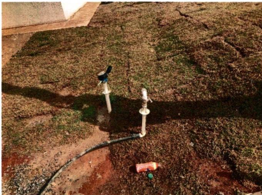
FOTO 33: ENTRADA DE ÁGUA
