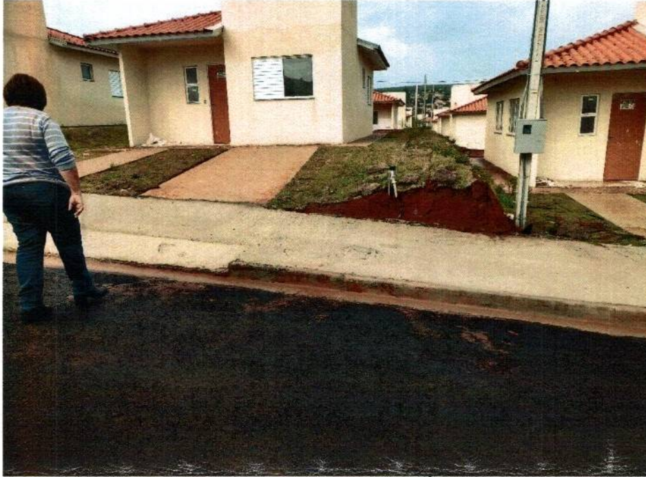
FOTO 28: ENTRADA DE ÁGUA
