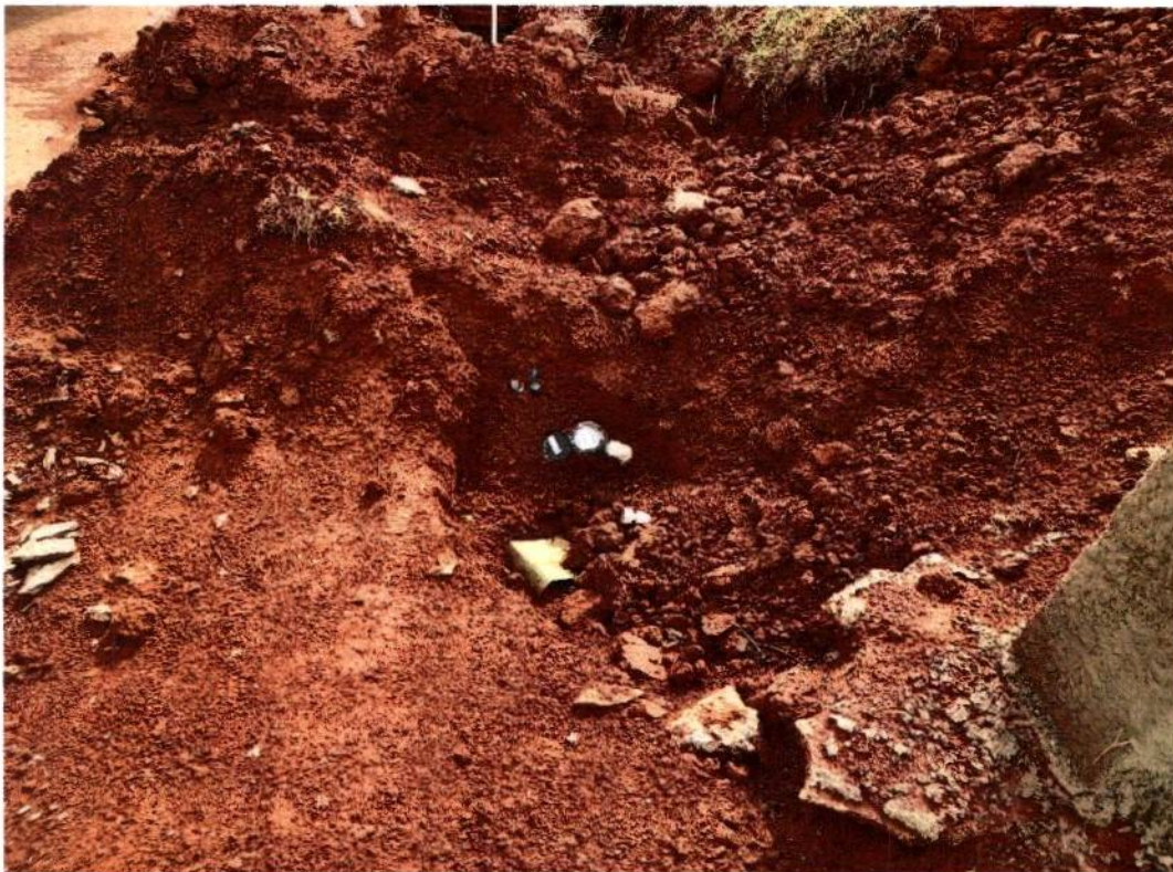
FOTO 31: ENTRADA DE ÁGUA
