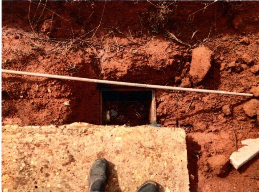
FOTO 34: CAIXA DE ESGOTO SANITÁRIO
