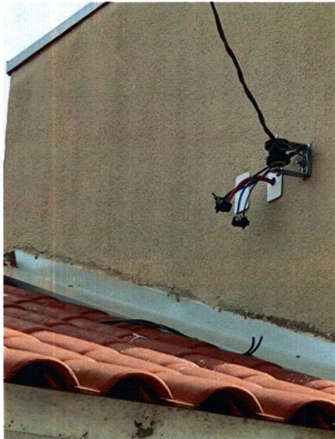
FOTO 10: FIAÇÃO EXPOSTA SOB A CALHA
