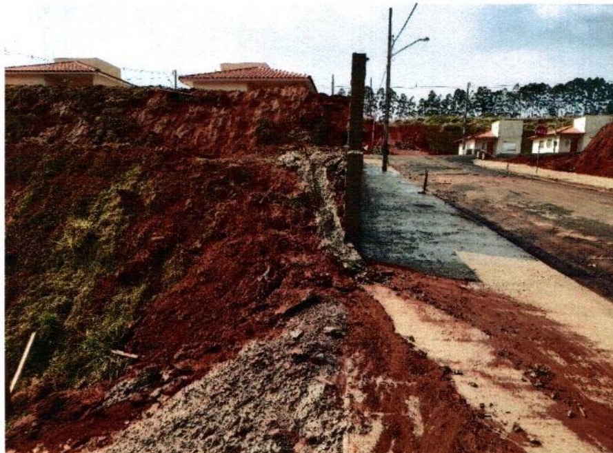
FOTO 12: TALUDE SEM COMPACTAÇÃO E SEM COBERTURA VEGETAL
