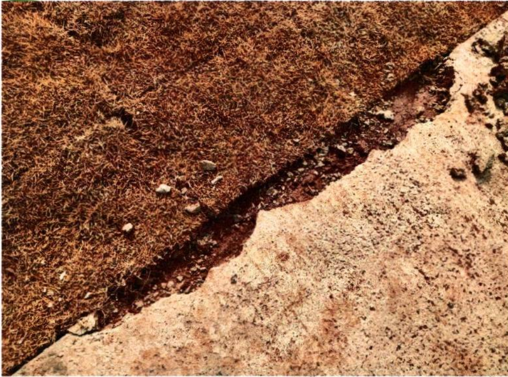
FOTO 17: CALÇADAS DANIFICADAS E NÃO ATENDEM CONDIÇÕES MÍNIMAS DE ACESSIBILIDADE
