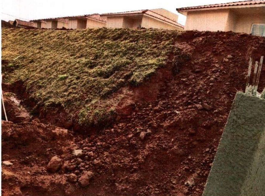
FOTO 11: TALUDE SEM COMPACTAÇÃO E SEM COBERTURA VEGETAL
