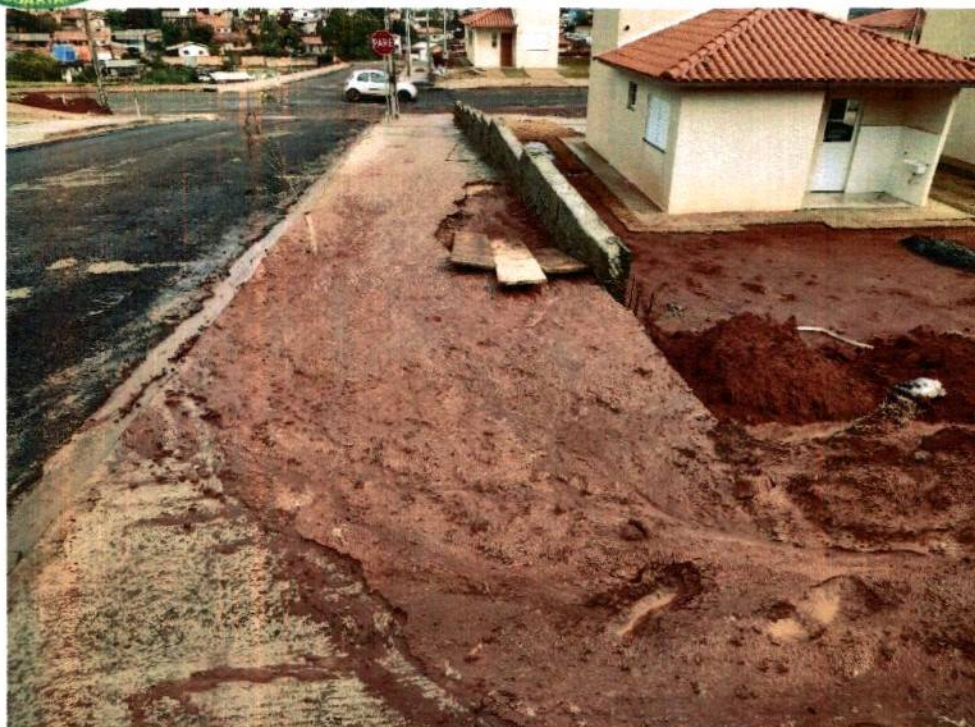
FOTO 02: MURO SEM ACABAMENTO AINDA NÃO FINALIZADO COM DRENAGEM PRECÁRIA E TALUDE AINDA NÃO FINALIZADO E SEM CAMADA VEGETAL
