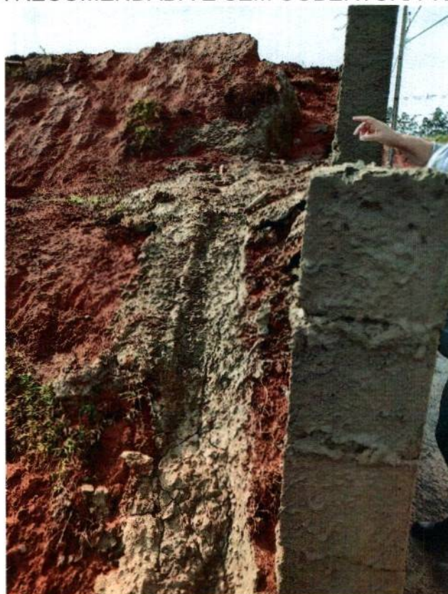
FOTO 14: TALUDE SEM COMPACTAÇÃO, COM INCLINAÇÃO SUPERIOR A MÍNIMA RECOMENDADA E SEM COBERTURA VEGETAL
