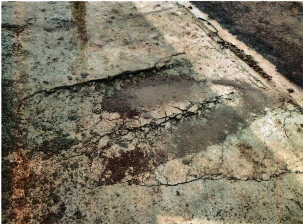
FOTO 18: CALÇADAS DANIFICADAS E NÃO ATENDEM CONDIÇÕES MÍNIMAS DE ACESSIBILIDADE
