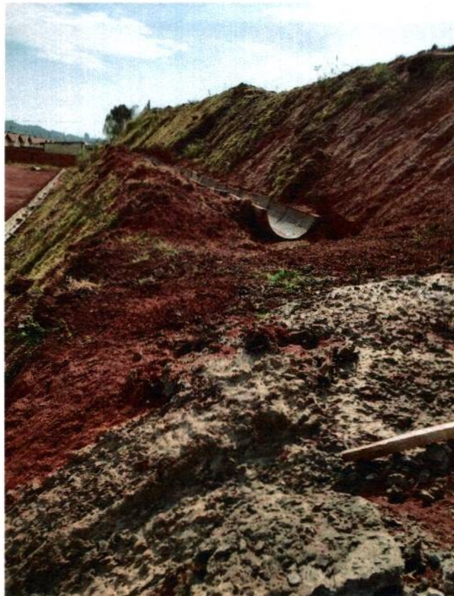
FOTO 27: CANALETAS DE DRENAGEM DE ÁGUAS PLUVIAIS
