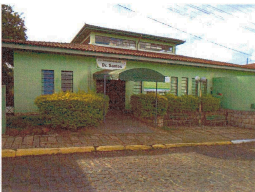
Figura 6 - condições da pintura externa
