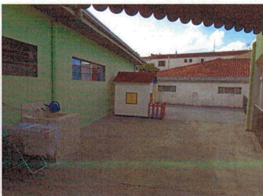
Figura 8 - condições da pintura externa
