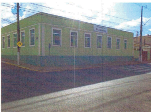
Figura 5 - condições da pintura externa
