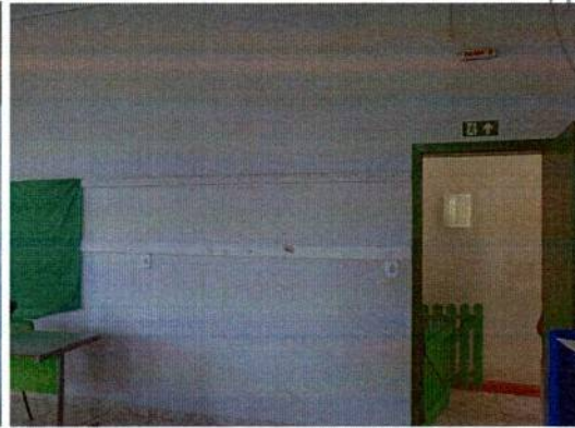
Figura 2 - condições da pintura interna
