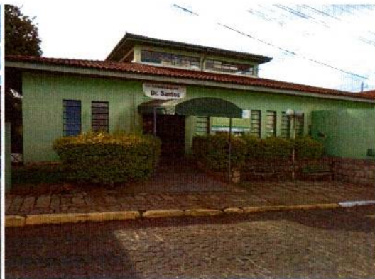
Figura 6 - condições da pintura externa
