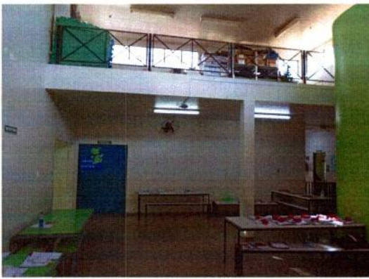
Figura 3 - condições da pintura interna
