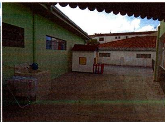
Figura 8 - condições da pintura externa
