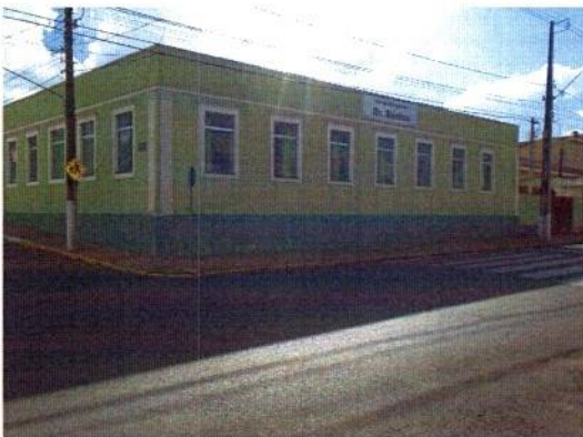
Figura 5 - condições da pintura externa
