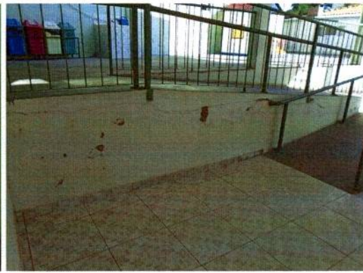
Figura 4 - condições da pintura interna
