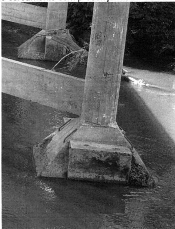
Figura 6 – Bloco de coroamento com presença manchas e de vegetação.
