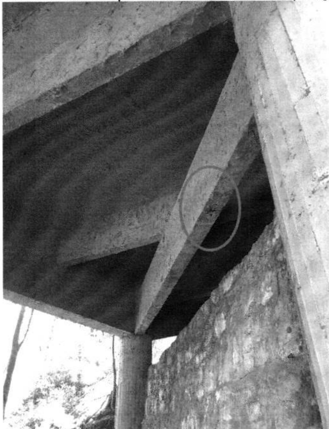
Figura 7 – Viga Transversina com perda de cobrimento e exposição de armadura
