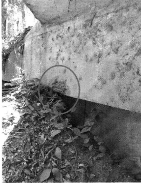
Figura 3 – Perda de cobrimento com exposição de armadura.
