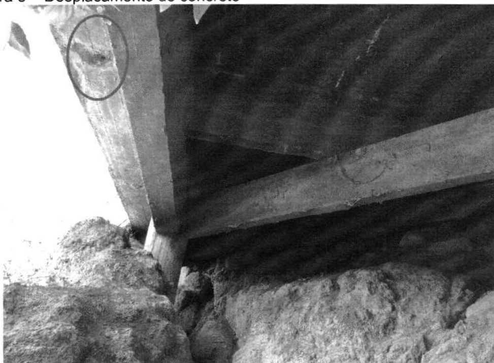
Figura 8 – Desplacamento de concreto
