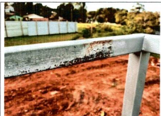
01 - PONTOS DE FERRUGEM
