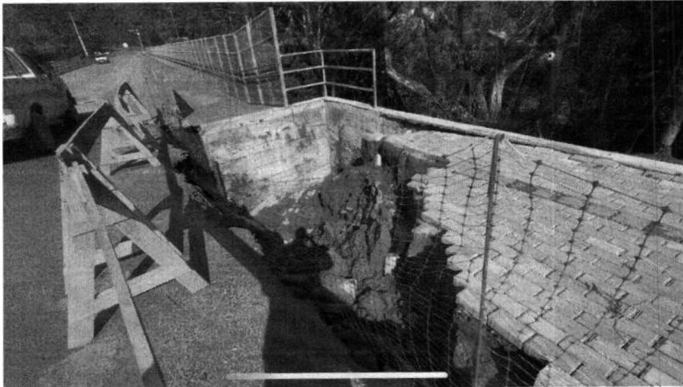
Figura 5 – Foto tirada no dia 08 de outubro de 2023 mostrando os danos na pavimentação do passeio.
