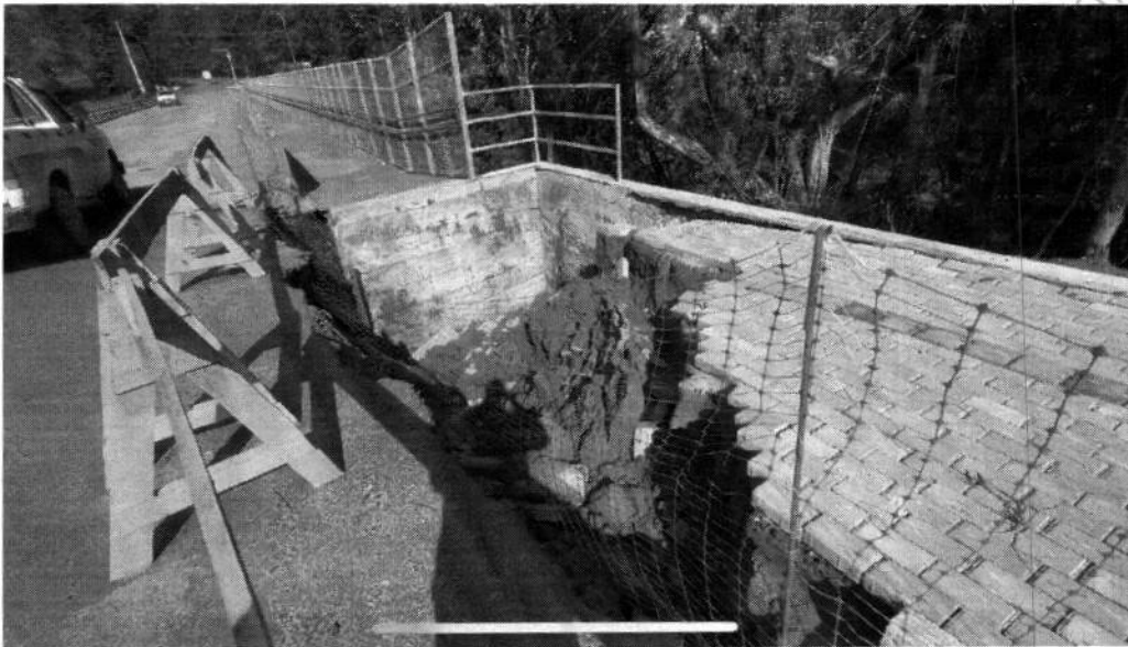
Figura 5 – Foto tirada no dia 08 de outubro de 2023 mostrando os danos na pavimentação do passeio.
