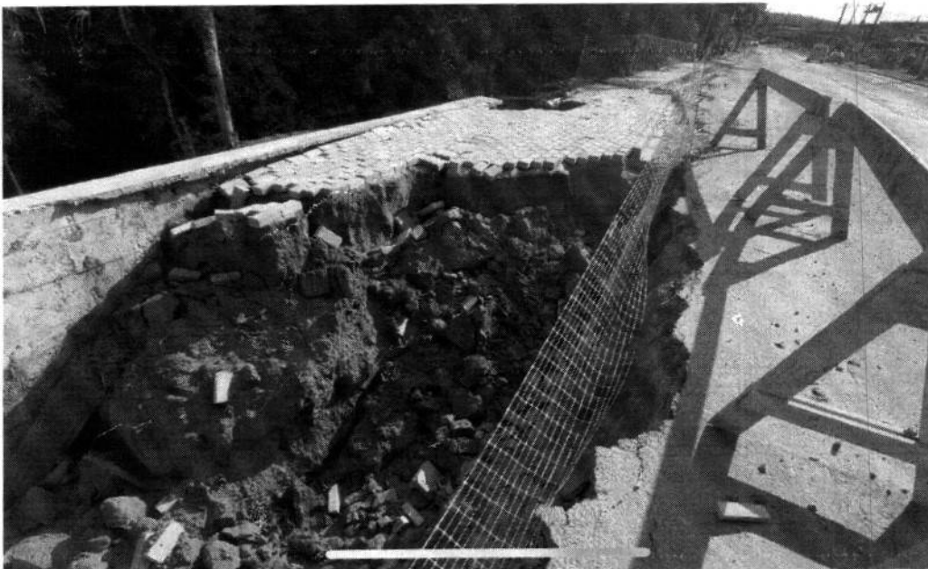
Figura 6 – Foto tirada no dia 08 de outubro de 2023 mostrando os danos na pavimentação do passeio.
