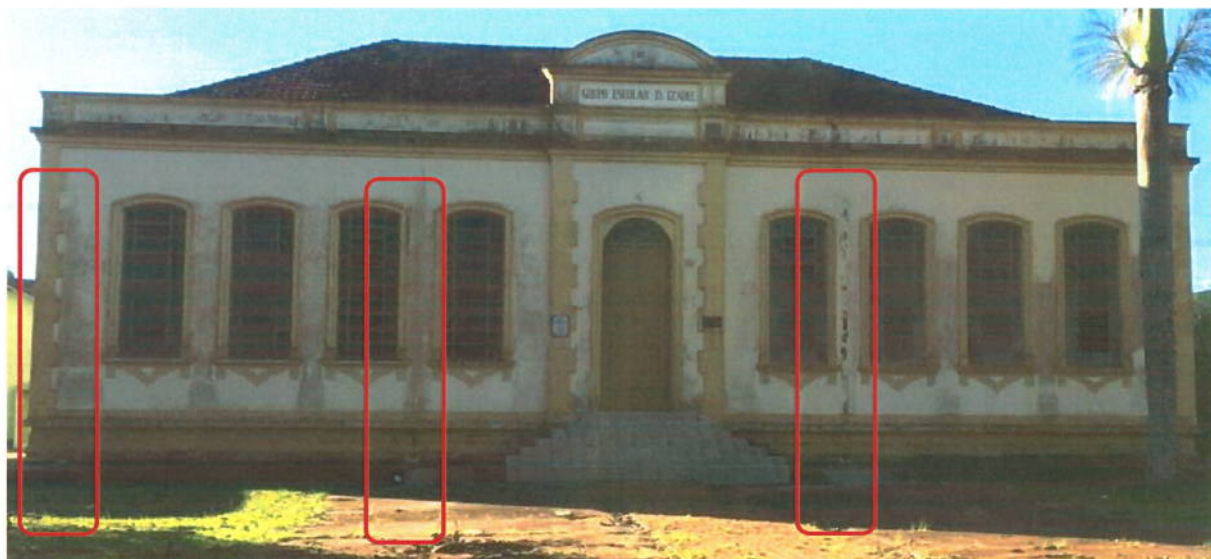
Foto: Fachada G.E. Izabel Branco com os prováveis vazamentos - fonte Prefeitura Municipal de Jaguariaíva
