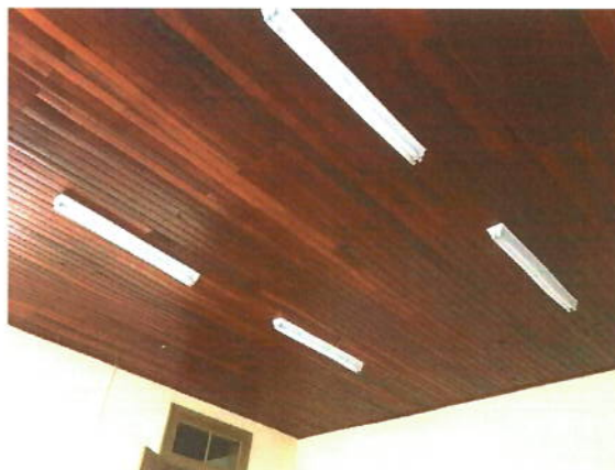
Foto: Forro de Madeira G.E. Izabel Branco Fonte Prefeitura Municipal de Jaguariaíva
