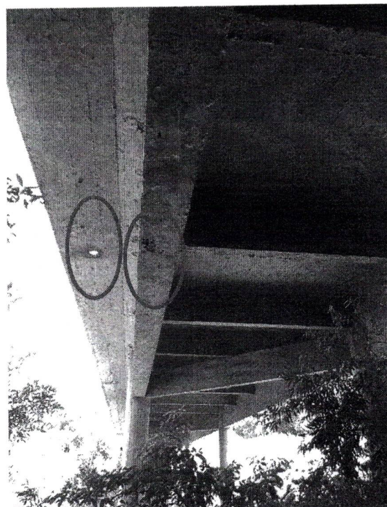
Figura 2 – Vigas com presença de ferrugem e ferragem exposta.
