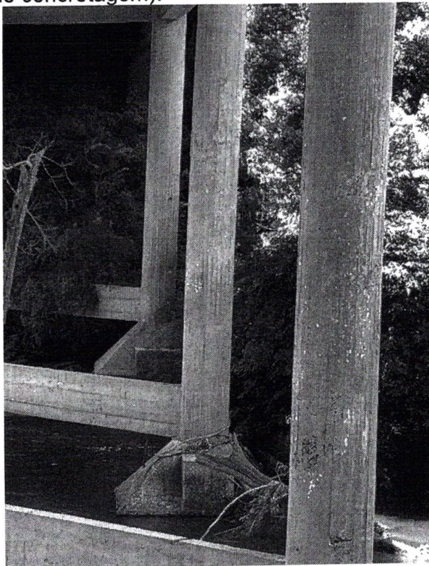
Figura 5 – Pilares de seção circular em concreto armado com segregação do concreto (ninhos de concretagem).
