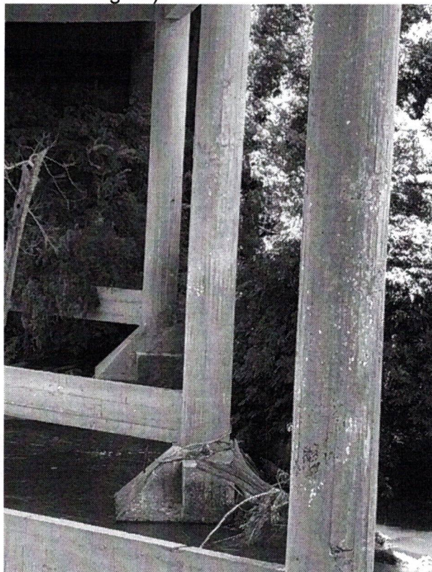
Figura 5 – Pilares de seção circular em concreto armado com segregação do concreto (ninhos de concretagem).
