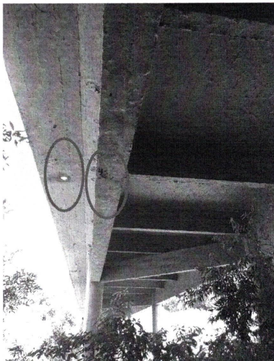
Figura 2 – Vigas com presença de ferrugem e ferragem exposta.
