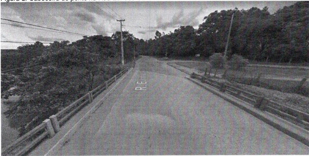
030 Figura 2: Cabeceira de ponte na Rua Eurides Cunha
