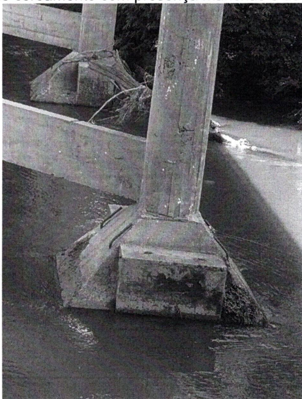
Figura 6 – Bloco de coroamento com presença manchas e de vegetação.
